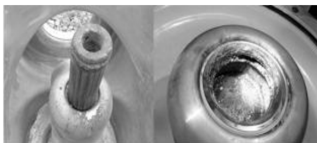
图 5 动、静触头的烧损情况
